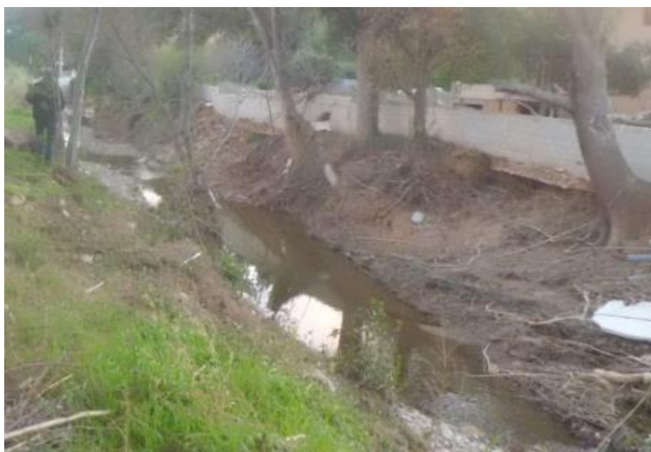
Figure 16 : Risque de présence d'embâcles dans le lit du Pansard, zone de Notre-Dame des Maures
